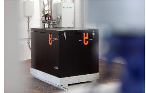
Blockheizkraftwerk © Berliner Energieagentur
