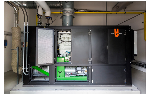
Installiertes BHKW © Berliner NetzwerkE, Dietmar Gust
