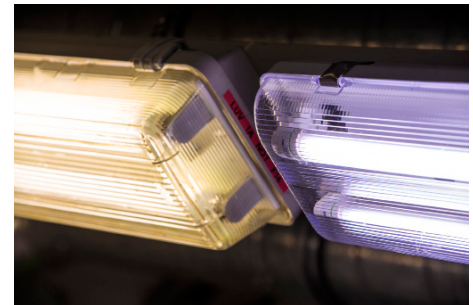
Neue LED-Leuchten ersetzen alte Leuchtstofflampen © Berliner NetzwerkE, von Plötz
