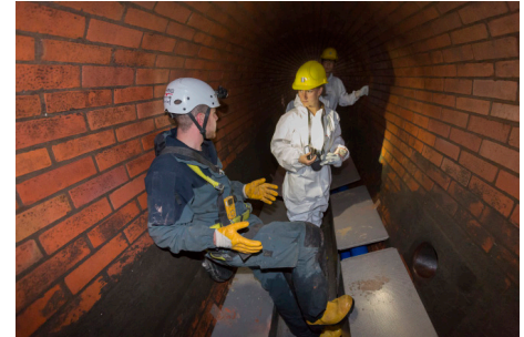
Kontrolle des Wärmetauschers © Berliner NetzwerkE, Dietmar Gust
