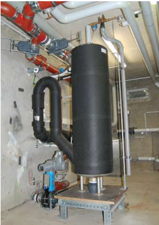
Foto 6: Zuleitung der gebündelten Abwassersammelleitung in den Aqua-Re-Energie-Trichter
