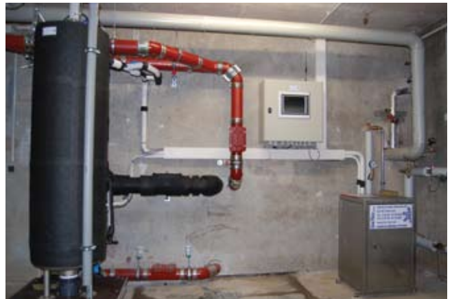
Foto 7: Isolierter Aqua-Re-Energie-Trichter und Wärmepumpe
