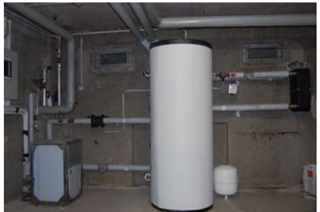
Foto 8: Pufferspeicher und Plattenwärmeübertrager im Heizkreislauf der Wärmepumpe
